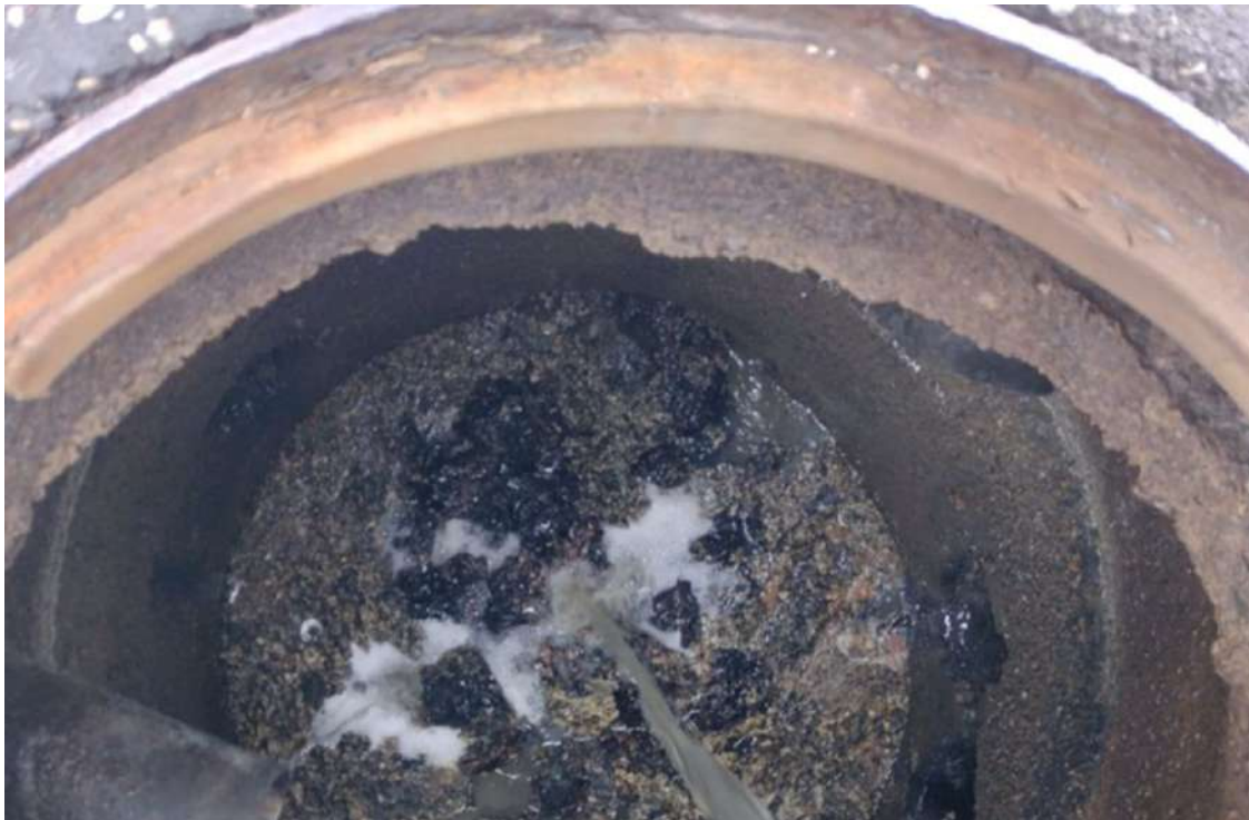
Cierran una playa en Tenerife por obstrucción de materiales de obra en la red de saneamiento. Ayuntamiento de Candelaria
